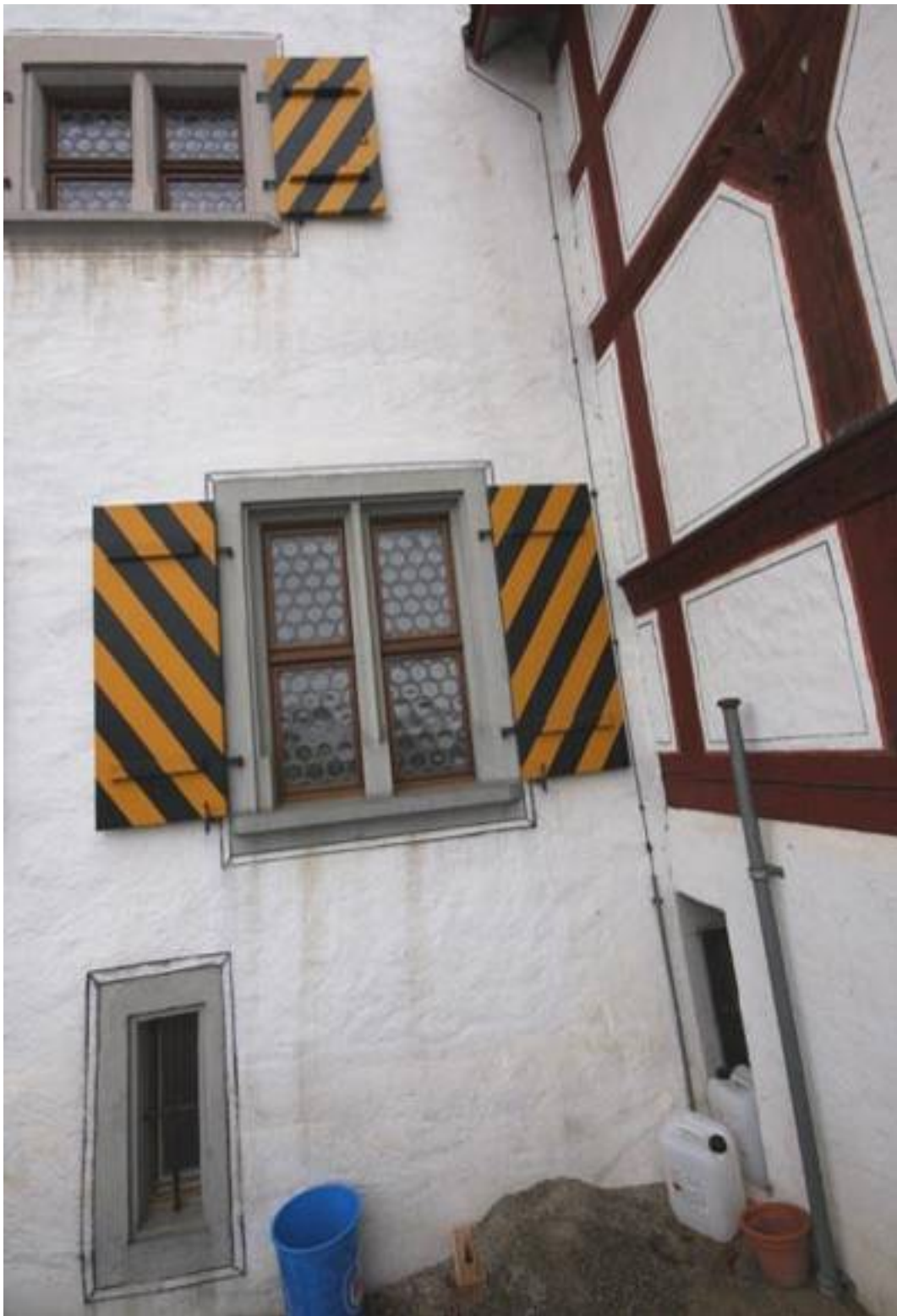
Am Herrenhaus sind ab 2002 die Fensterläden neu gestrichen und die Fensterflügel aufgefrischt worden. Die Fassade zeigt noch den Anstrich von 1979. Schmutz und auskheidender Anstrich verursachen Schmutzränder unterhalb der Fensterbänke.
