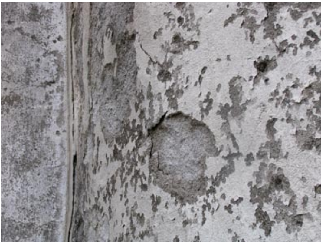
Infolge von einem Feuchtigkeitsstau, verursacht durch den luftdicht abschliessenden Anstrich, löst sich die Putzschicht ab, der Putz ist morbide und hat keine Bindekraft mehr.
