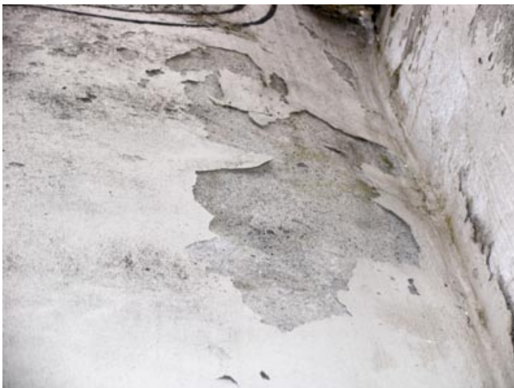
Auf einer grösseren Partie blättert der Anstrich mit dem Verputz ab.
