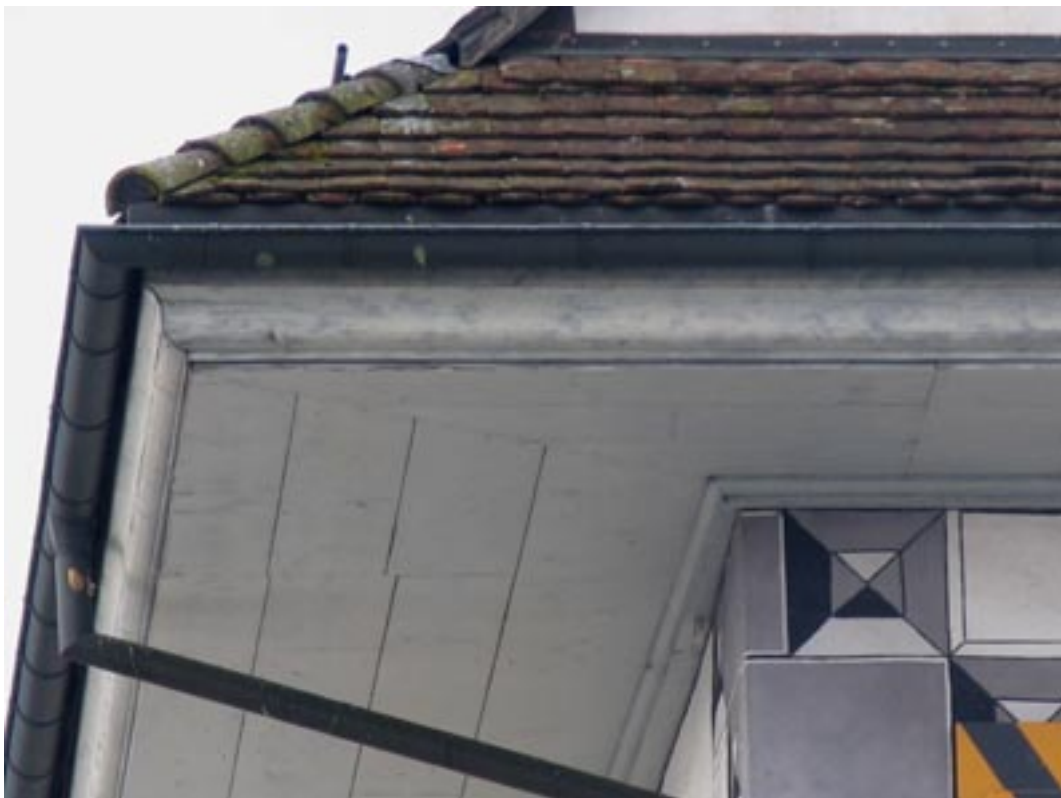
Die Untersicht am Herrenhaus konnte nicht überprüft werden. Es zeigen sich keine Schäden. Der Anstrich ist vermutlich ausgebleicht und zeigt heute einen hellen Grauton.
