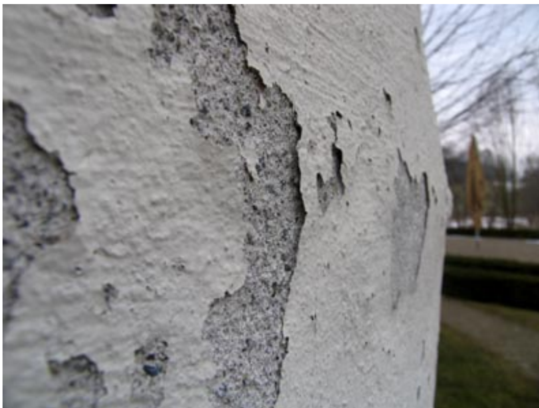
Der Anstrich reisst die obersten Millimeter der Putzschicht ab. Grössere Partien blättern ab.
