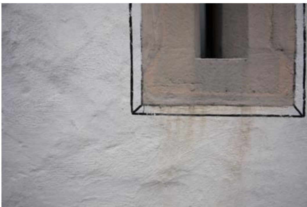
Der Farbanstrich auf den Gewänden des Herrenhauses kriedet aus. Der Anstrich ist stark ausgebleicht und verfärbt.
