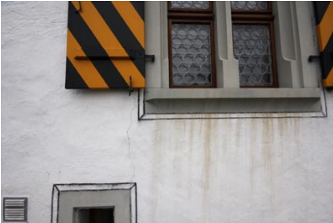
Auskreidender Farbanstrich und Schmutzwasser werden unterhalb der Fensterbänke über die Fassade „gespült“
