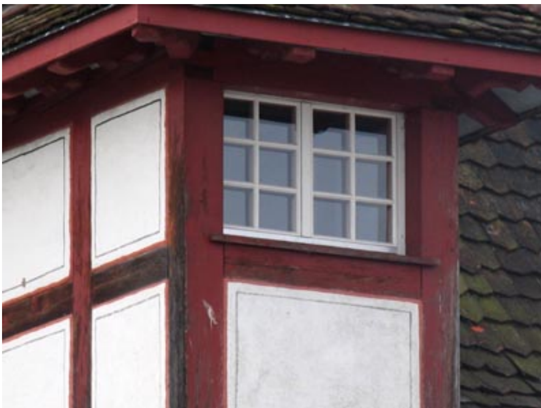
Auf den Holzteilen des Fachwerks blättert die Holzdispersion an Partien die stark der Witterung ausgesetzt sind ab.
