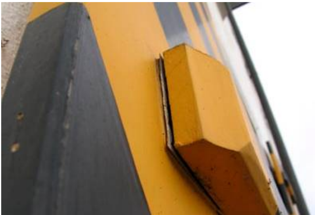
Die Gratleiste ist bei verschiedenen Fensterläden vom Laden gelöst. Hier ist ein grosses Gefahrenpotential vorhanden. Die Läden sind mit einer Holzdispersion gestrichen, eindringendes Wasser kann hier zu massiven Schäden führen.
