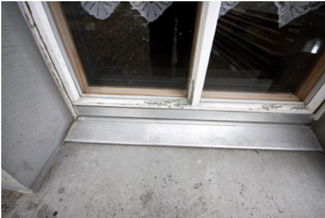
Der Fensteranstrich beim Klösterli und Zwischentrakt ist mehrheitlich intakt. Es zeigen sich nur vereinzelte kleinere Schäden.
