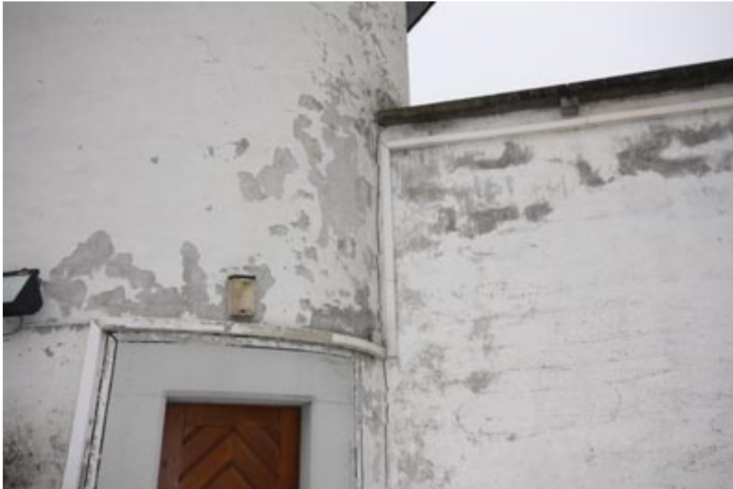
Auf der Hofseite des Südwestturms ist das Schadenbild geringer. Aber auch hier sind Putzabplatzungen zu verzeichnen.
