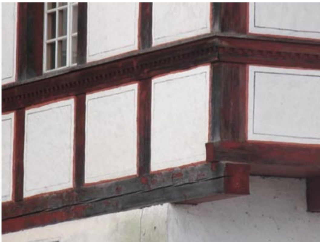
Stark verwitterte Holzbalken am Zwischenbau.
